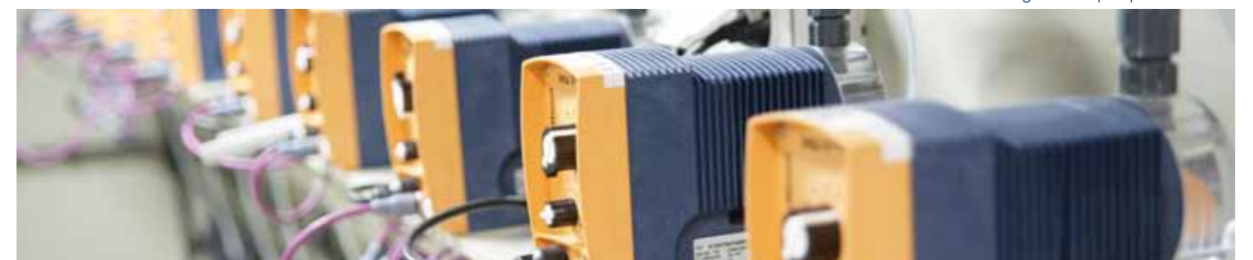
Magnetdosierpumpen im Einsatz
